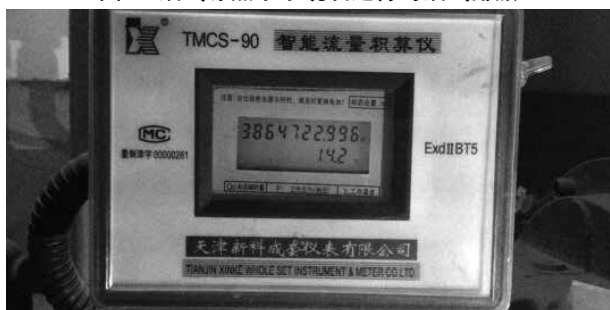
图5 燃气表显示天然气进锅炉温度为 14.2℃
