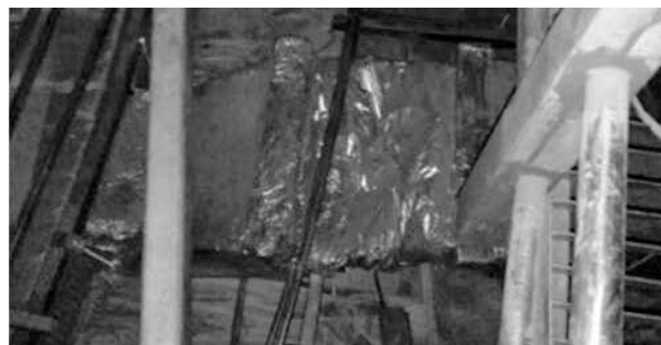
图 6 送风软管被穿线管压瘪
