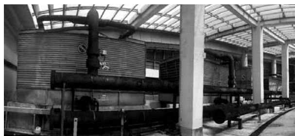
图 12 冷却塔系统全貌
