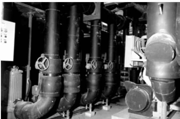
图4 水源热泵机房(水泵部分)
