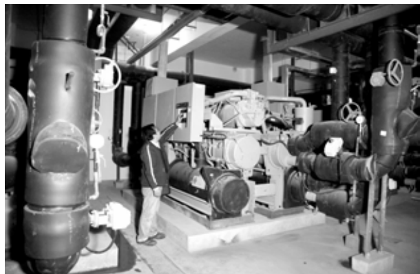
图2 水源热泵机房（水源热泵机组部分）
