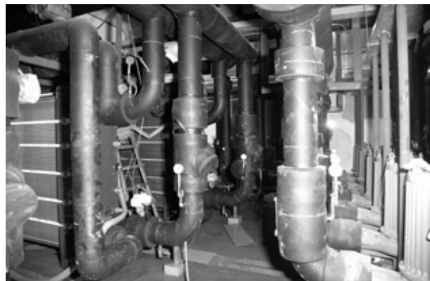
图3 水源热泵机房（换热部分）
